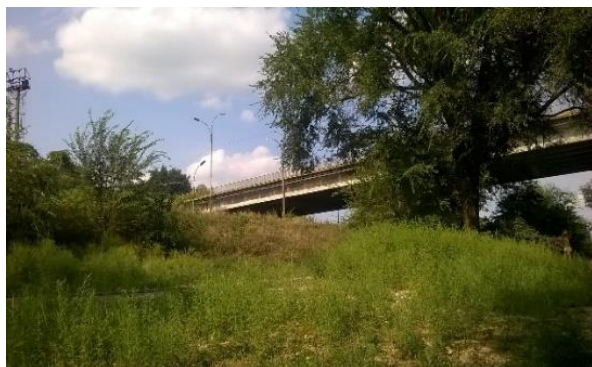
Figura 24. Căile de acces neamenajate și nesigure în zona Ungheni Vale
