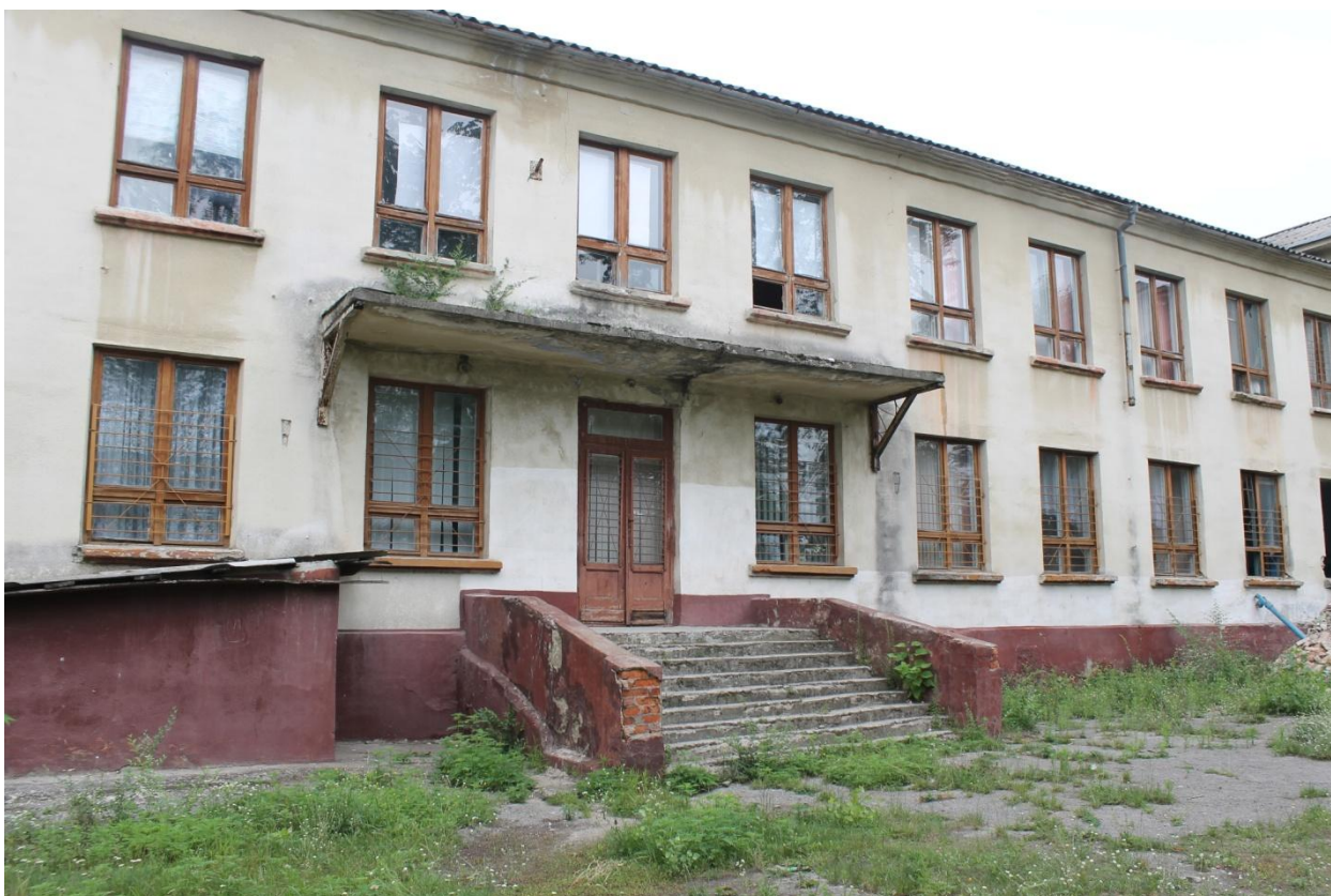
Imaginea nr. 24: Intrarea centrală în Gimnaziul „A.I.Cuza”. Actualmente neutilizată din cauza pragului deteriorat, acoperișului acestuia și terenului neamenajat Sursa: Vizite de observare (septembrie 2018 – februarie 2019)
